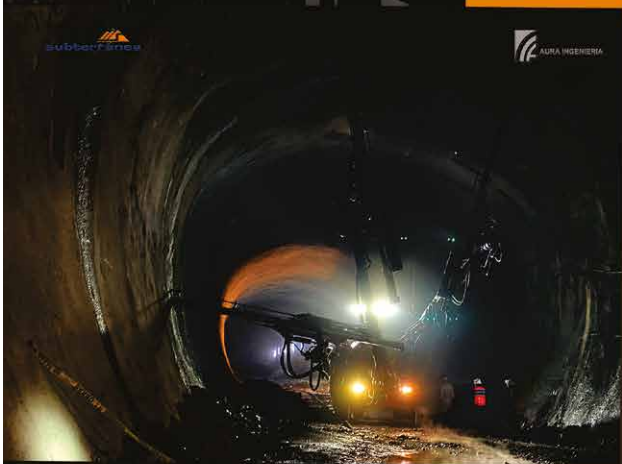
Perforación de taladros para cortinas de impermeabilización en Tunnel OLLACHEA/JUMBO electro hidráulico DT1131 I de 3 brazos.
